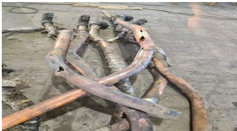
图 4 短网放电对于短网的损坏现象
